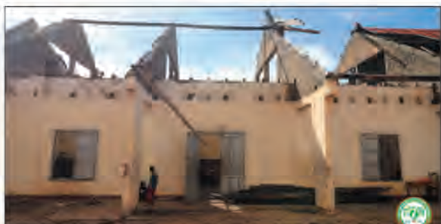
Les infrastructures scolaires sont les plus touchées par le cyclone Freddy.
