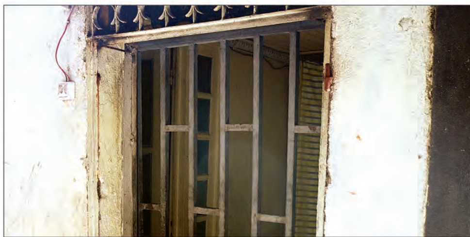
Les vols de portails métalliques se multiplient dans le quartier des 67 ha.
