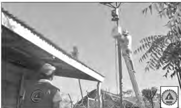
Des équipements ont été placés à Morondava et Mahabo pour renforcer le système d'alerte précoce (photo BNGRC).
