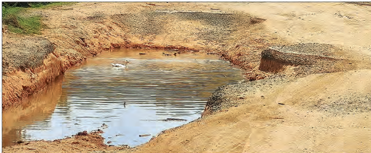
C'est l'état de dégradation de route sur la RN6.
