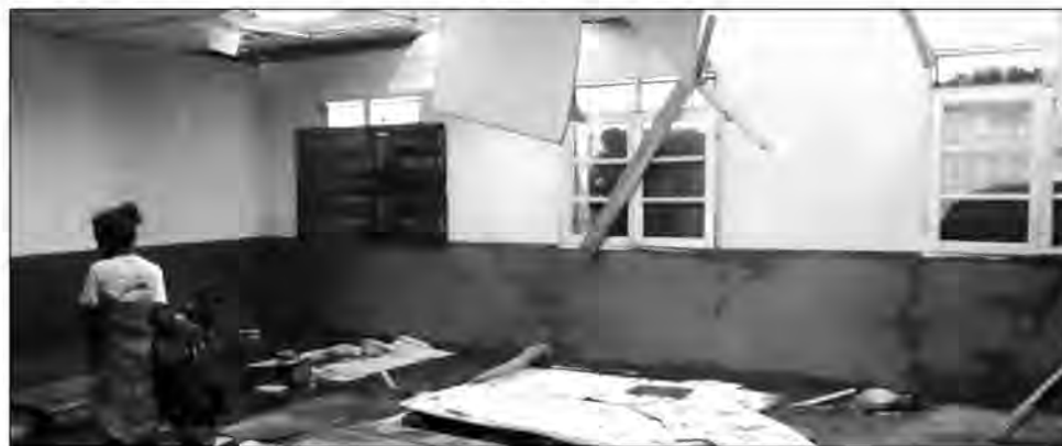
Les dégâts matériels sont importants.
