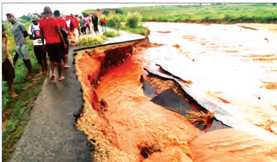
L'affaissement d'une large partie de la route au croisement d'Anjajia a rendu toute circulation impossible depuis hier.
