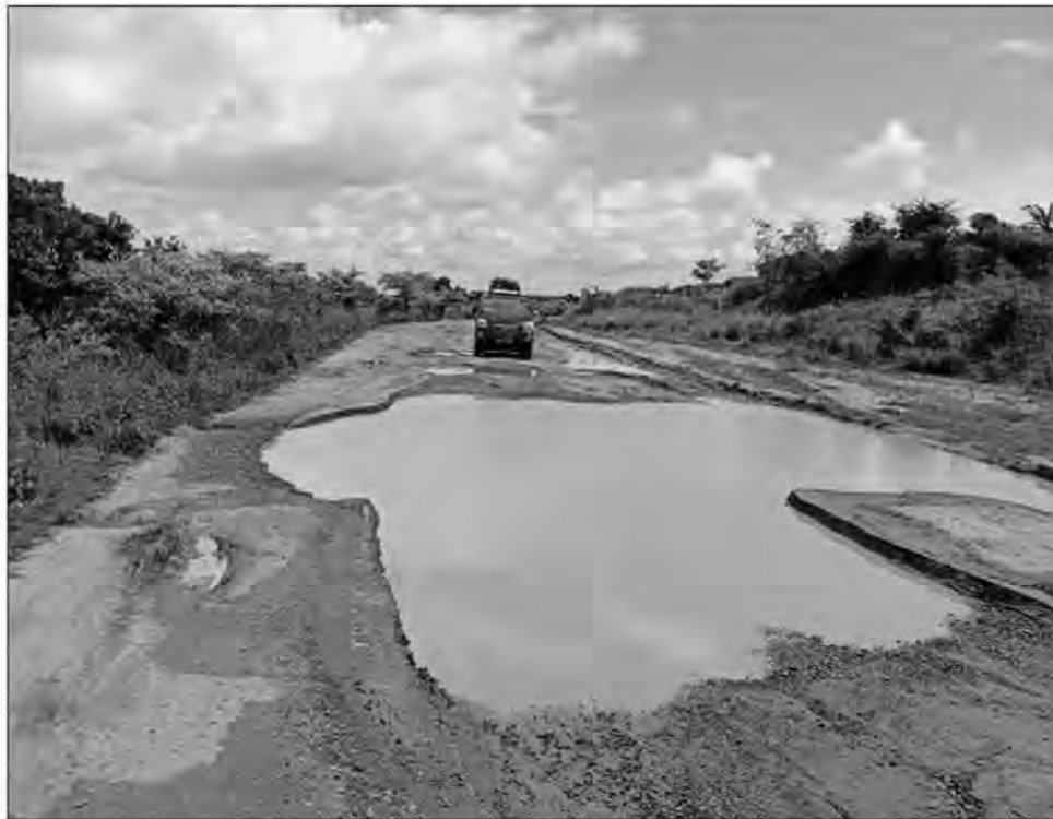
Au croisement d'Anjajia sur la RN4, la chaussée s'est affaissée.
