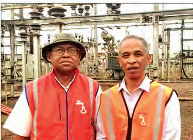
Cheneso a causé des dégâts sur les infrastructures de distribution d'électricité de la Jirama.
