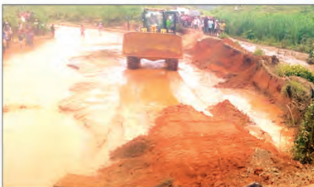
Les engins intervenant au niveau d'un point de rupture de la route nationale n°4.
