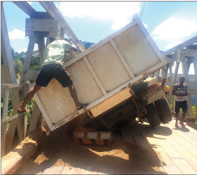
Une partie du pont reliant Ambohimambola et Masindray s'est écroulée au passage d'un camion transportant du sable de rivière.
