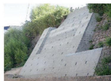
Rehabilitation du mur de soutènement dans la Haute ville - Travaux d'urgence du projet Lalankely III
