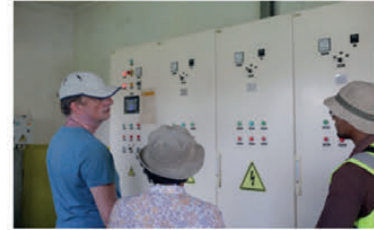
Visite de M. Géraud GUIBERT à la station de relevage à Anatihazo avec le Directeur Technique de l'APIPA
