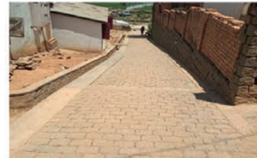
Rehabilitation d'une voie carrossable à Avaratezana CUA - Travaux 2ème phase du projet Lalankely III
