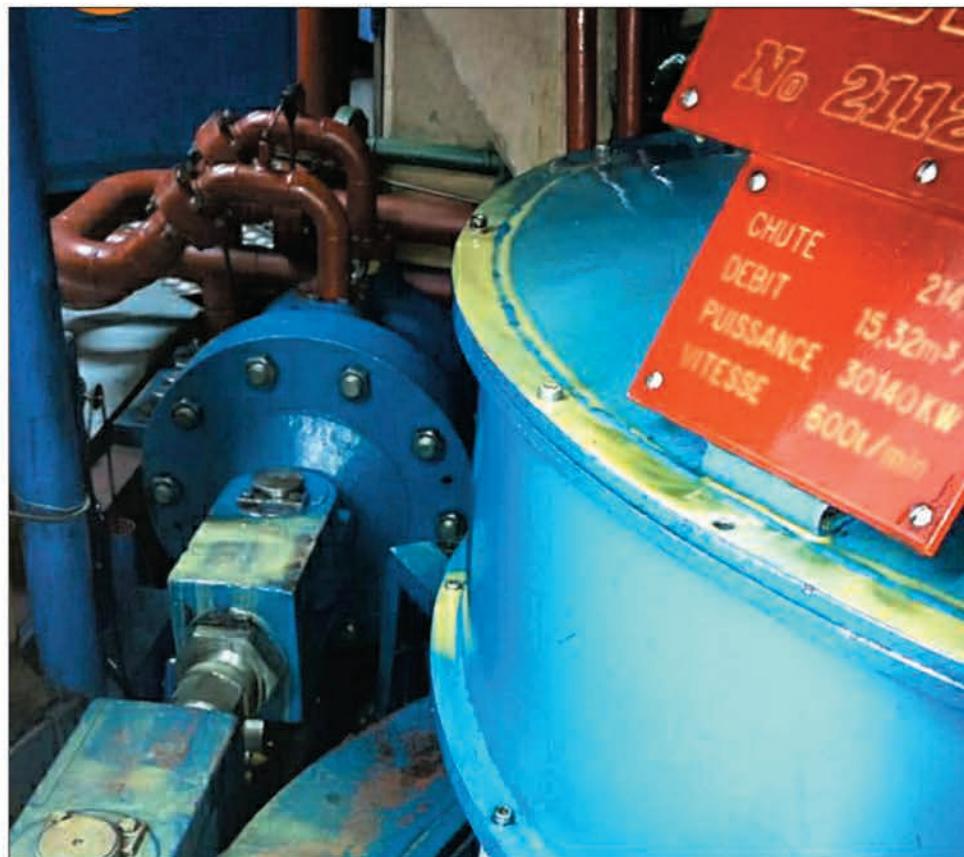
Émulsion d'huile au niveau du groupe G2 de la centrale d'Andekaleka.
